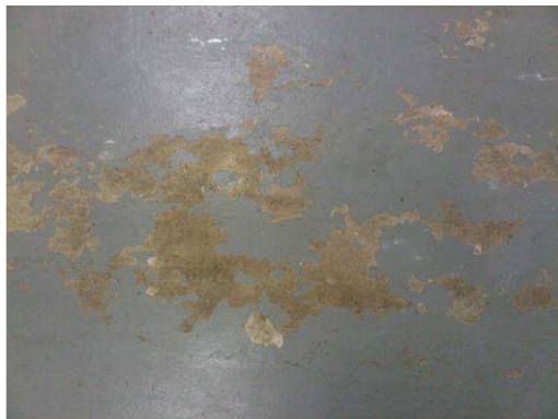
der alte EP-Anstrich platzt ab
