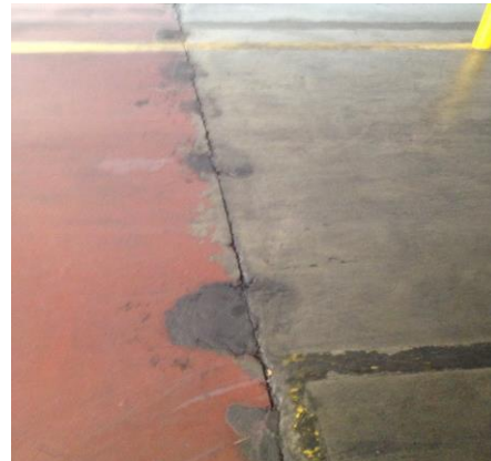
Fugen sind ausgebrochen.
